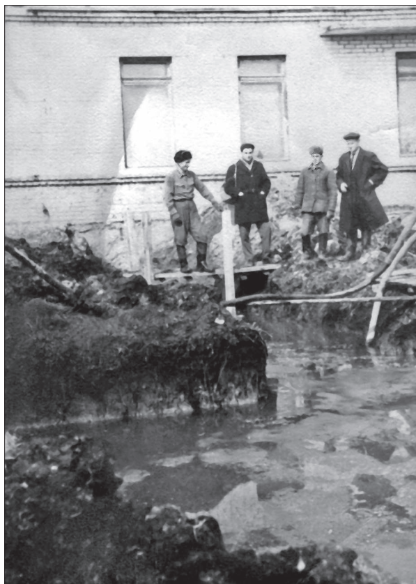
Строительство Комплексной магнитно-ионосферной станции «Ключи», 1964 г. Слева направо: электрик Д.Т. Деменский, сотрудник ОМТС В.Г. Карпенко, электрик А.С. Сидоров, гл. инженер К.Г. Сосунов
